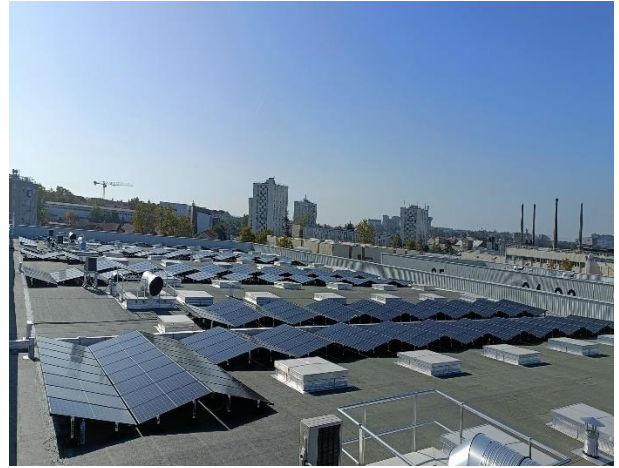
Centrale photovoltaïque en toiture des lots 2 et 3 (en service depuis février 2024)
